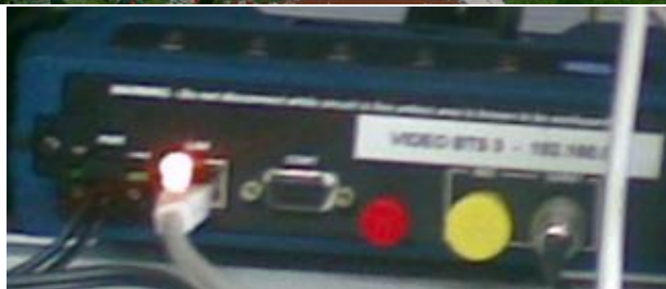
Relais local Mercury 900 en « volant » installé en 15 minutes sur la terrasse du CIC
